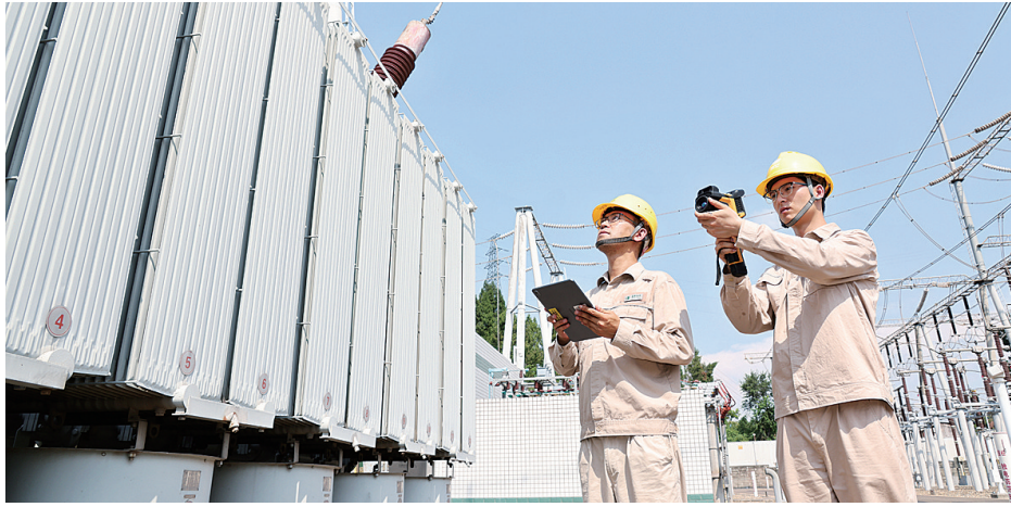
运维人员正在对供电主设备进行测温巡检。
