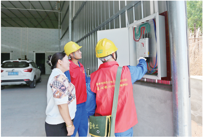
党员服务队队员检查农场柠檬冻库电气控制设备。
