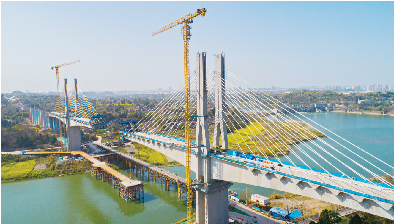
成达万高铁资阳沱江特大桥位于资阳市雁江区,主桥全长622米,设计时速350公里,主跨为320米的矮塔斜拉桥。目前,在建设人员日夜攻坚下,该桥即将合龙。 全媒体记者 王勇 摄
