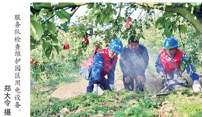
服务队检查维护园区用电设备。
