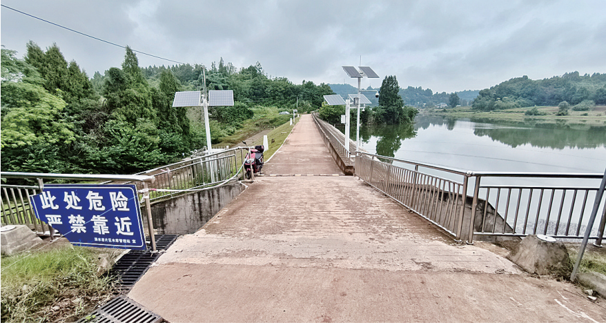
水库大坝连接桥左侧护栏缺失。《资观帮忙》报道组供图
